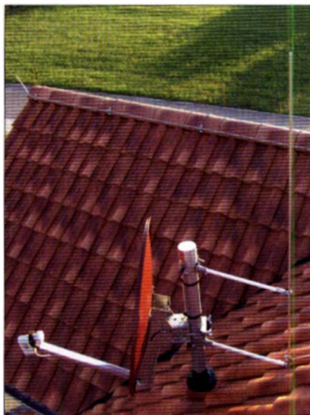
Bild 5: Vorschriftsmäßige Fangstange, isoliert an einem Antennenmast angebracht Werkfoto: Dehn & Söhne
